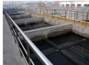
(f) 污水处理池
